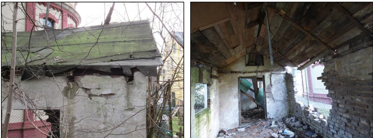
Abbildung 13: Einsturzgefährdeter Schuppen im südlichen Bereich der Gartenbrache
