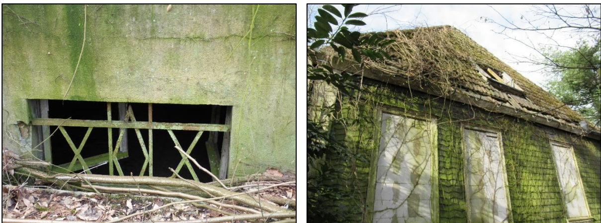
Abbildung 11: Geöffnete bzw. beschädigte Fenster im Keller (links) und im Dach (rechts)
