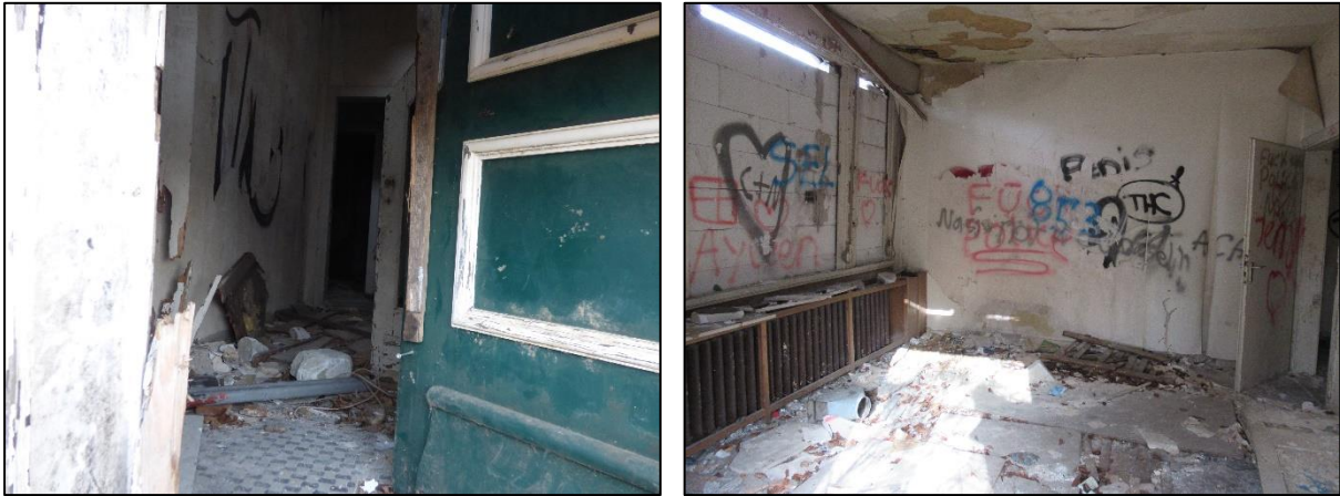
Abbildung 12: Innenbereiche des verfallenen Villengebäudes
