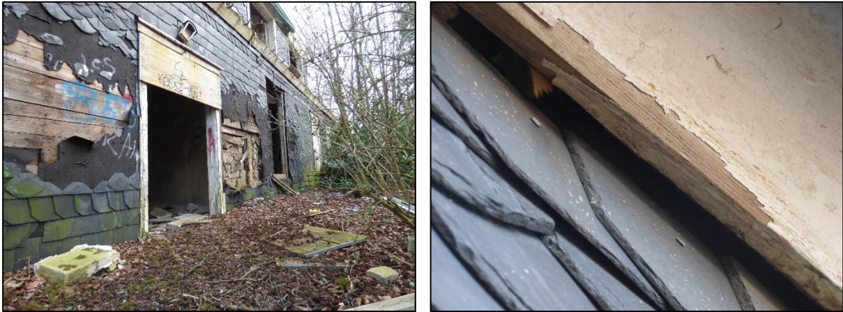
Abbildung 10: Beschädigte Tür und Schieferverkleidung / Ortbrett mit großem Spaltmaß
