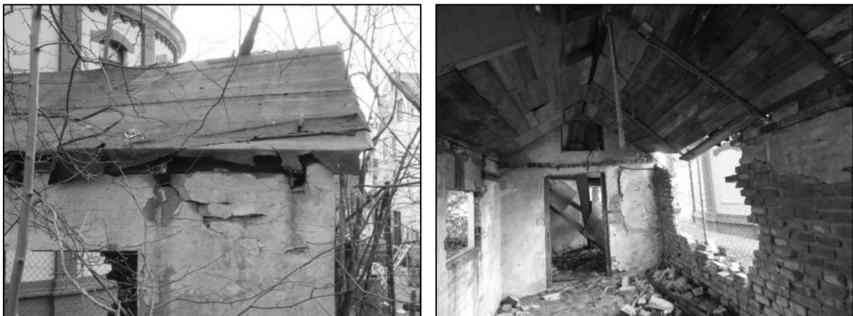
Abbildung 13: Einsturzgefährdeter Schuppen im südlichen Bereich der Gartenbrache
