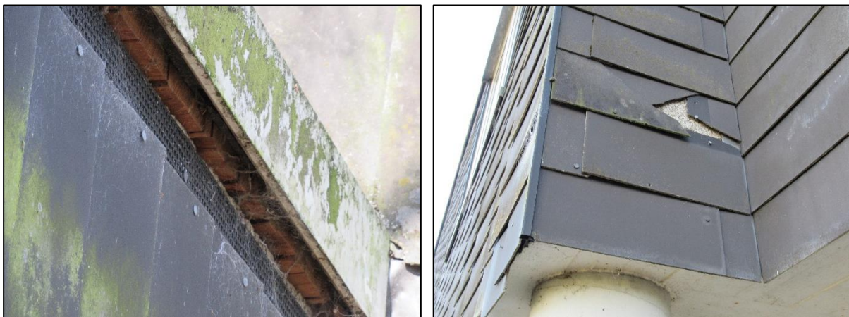
Abbildung 10: Potenzielle Einflugmöglichkeit unter der Blechattika / Beschädigung an der Schieferverkleidung des ehemaligen Vereinsheimes
